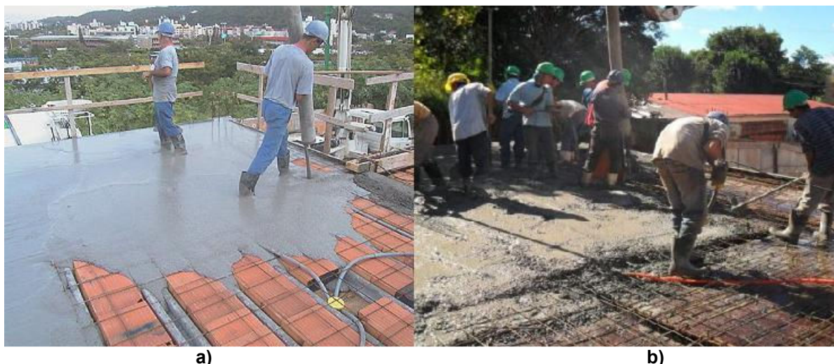
Figura 3: a) Concretagem com CAA b) Concretagem em CCV Fonte: Adaptado de REPETTE, 2008.
