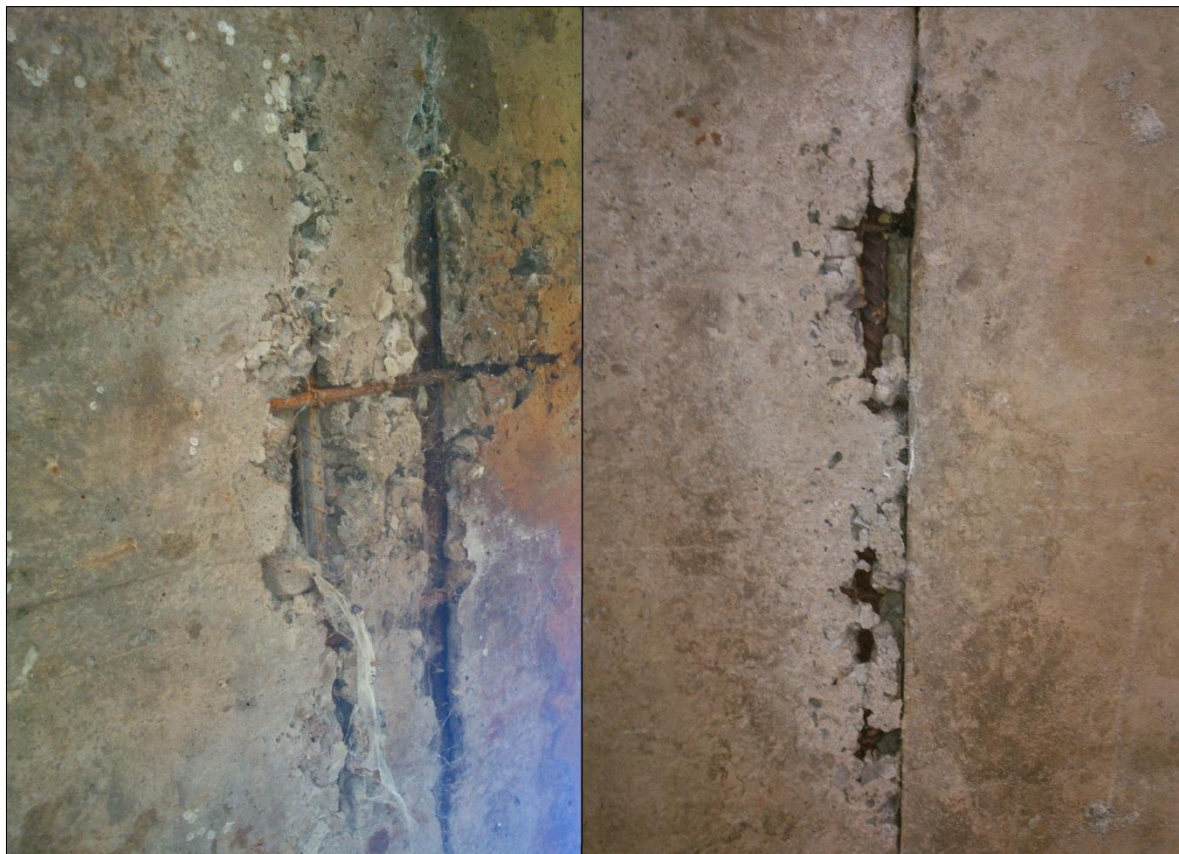
Figura 15 – Inconformidades encontradas na ponte sobre o Rio Independência Fonte: Os Autores (2014).
