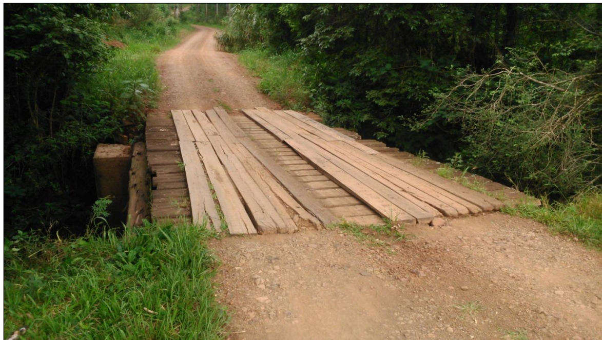
Figura 19 – Ponte de madeira existente sobre o Rio Lajeado Grande Fonte: Os Autores (2014).
