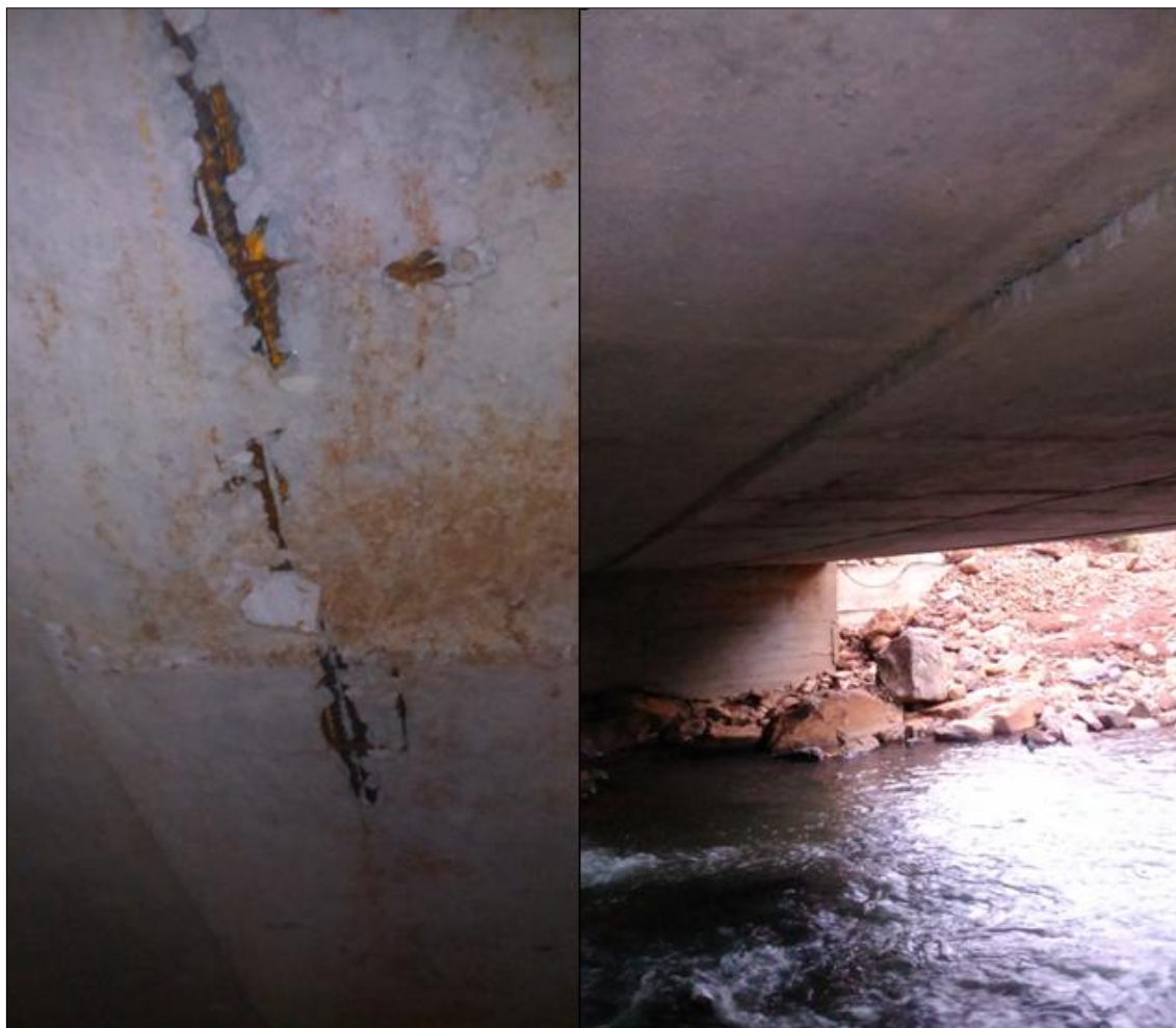
Figura 18 – Inconformidades encontradas na ponte sobre o Rio Capanema Fonte: Os Autores (2014).
