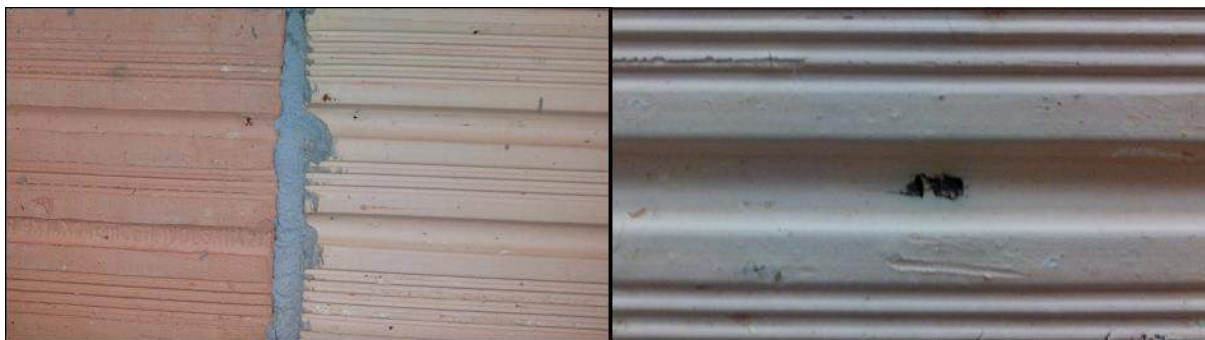
Figura 27 – Heterogeneidade nos blocos cerâmicos Fonte: Autora (2014).
