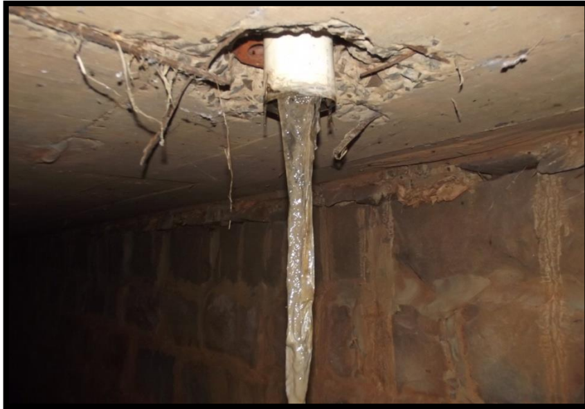
Figura 25 - Ligação clandestina de esgoto no trecho canalizado do Córrego da Várzea Fonte: Autores, (2013).
