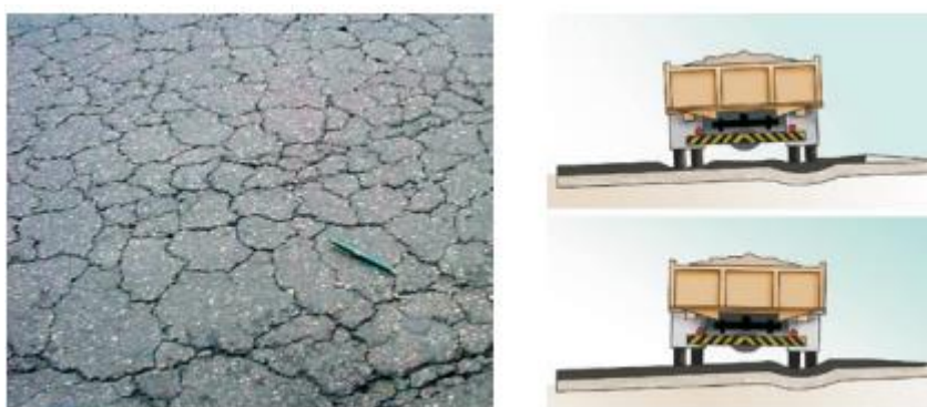
Figura 10 – Trincamento e afundamento permanente por repetição de cargas. Fonte: Bernucci et al. , 2008.
