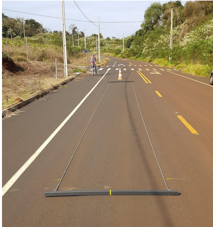
Figura 44 – Levantamento topográfico com Nível e Mira na rua Benjamim Borges dos Santos Fonte: Própria, 2018.
