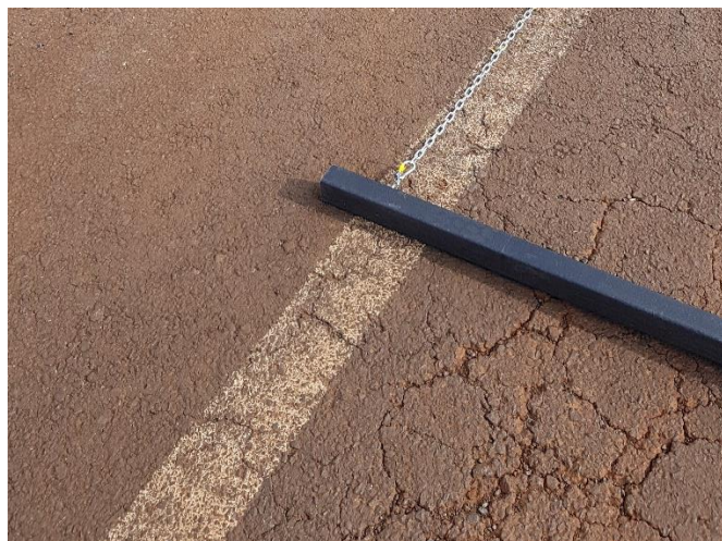
Figura 42 – Defeitos na rua Irineu Parzianello Fonte: Própria, 2018.
