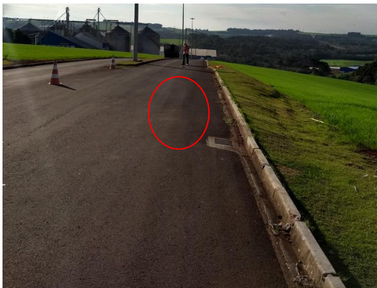
Figura 62 – Final do trecho analisado na empresa Sementes Guerra, com detalhe de visualização das deformações permanentes nas trilhas de roda. Fonte: Própria, 2018.
