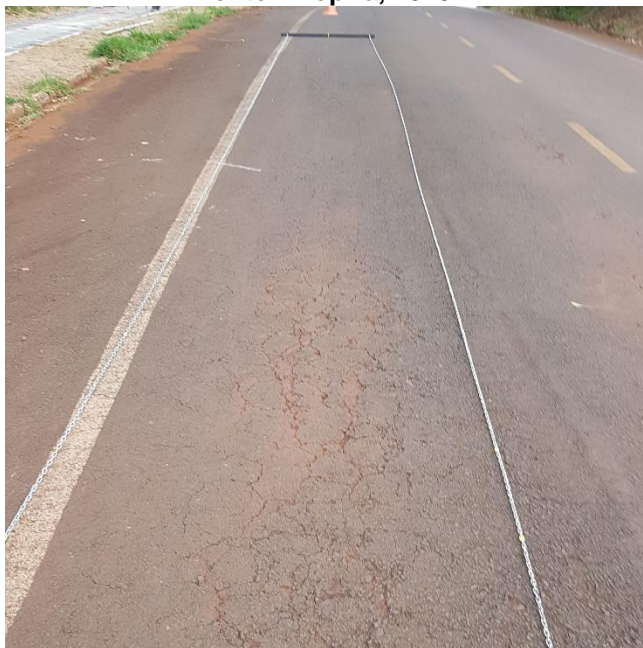
Figura 41 – Condição da rua Irineu Parzianello Fonte: Própria, 2018.
