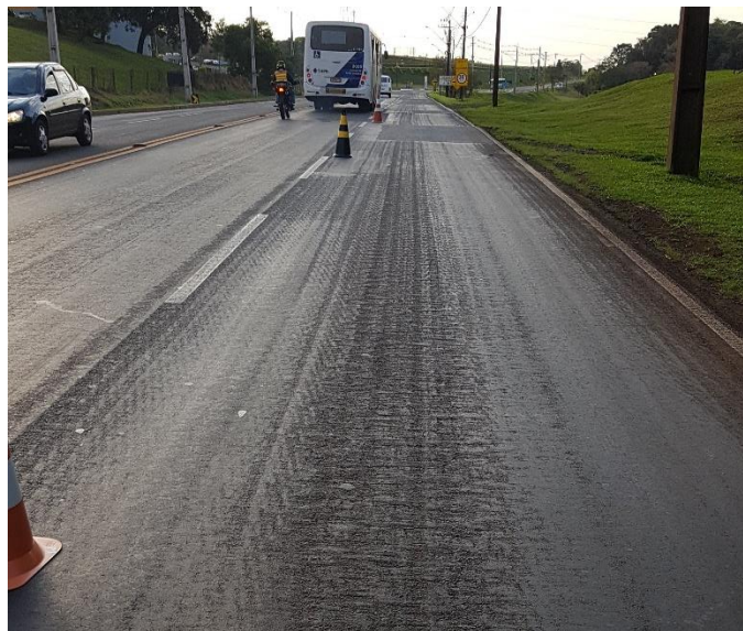
Figura 50 – Afundamentos nas trilhas de roda Fonte: Própria, 2018.
