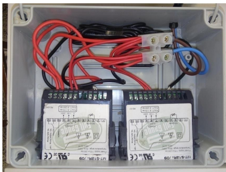
Figura 27 - Vista interna da caixa de distribuição
