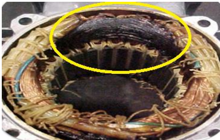
Figura 23 Dano por falta de fase na alimentação do motor Fonte: Manual técnico redutores SEW
