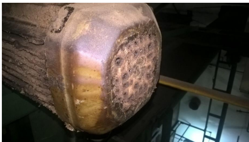
Figura 13 Tampa da ventoinha esta totalmente obstruída por sujeira. Fonte: Autor
