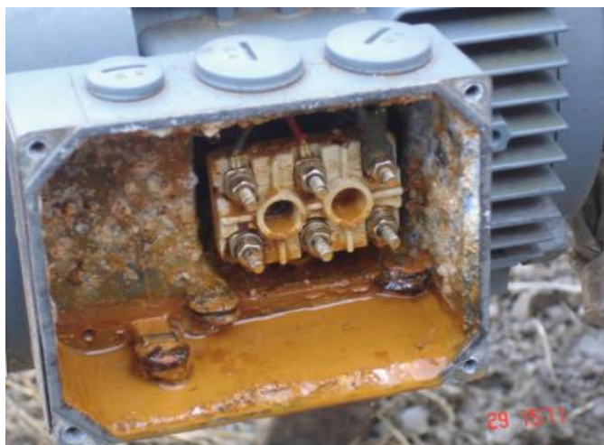
Figura 11 Dano por infiltração de água na caixa de ligação do motor Fonte: Manual técnico redutores SEW
