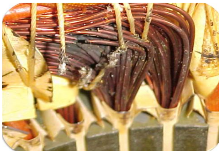
Figura 21 Curtos entre as bobinas de um motor Fonte: Manual técnico redutores SEW
