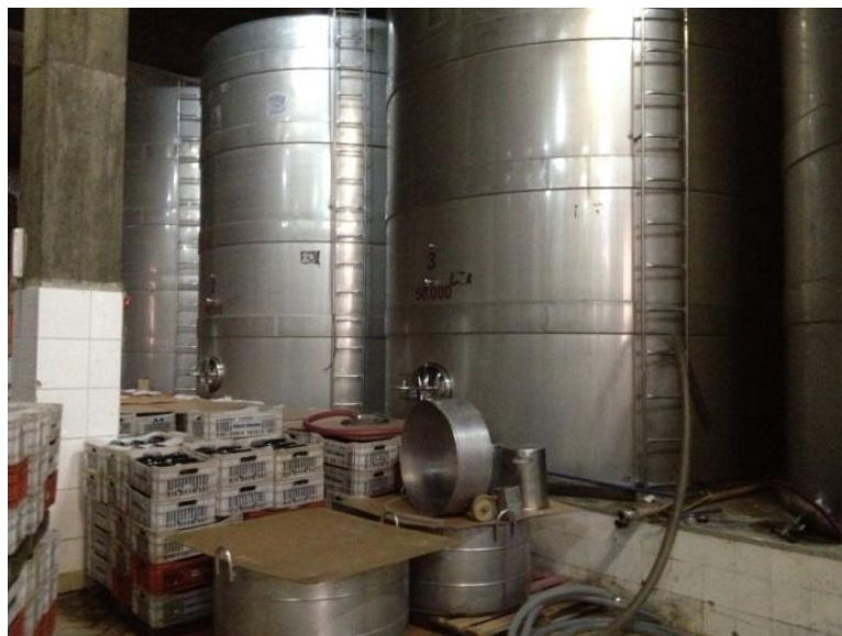
Figura 3 – Tanques de Decantação de uma vinícola
