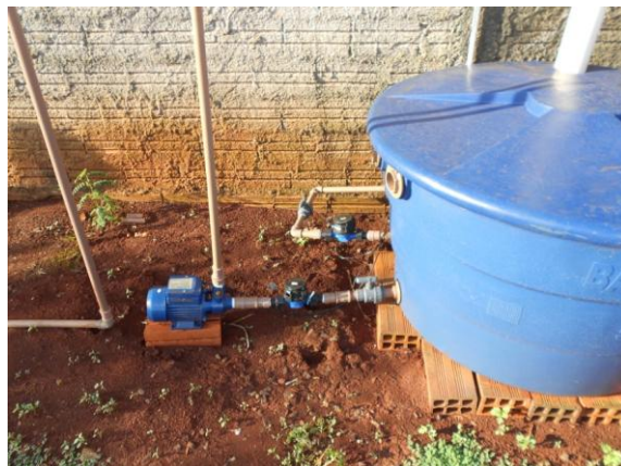
Figura 8 – Motobomba Fonte: Autoria própria
