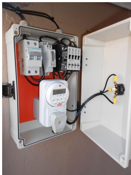
Figura 4 – Quadro de controle da irrigação Fonte: Autoria própria
