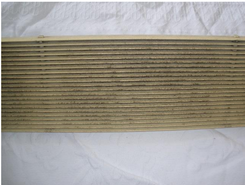
Figura 17: Foto da grelha com a presença de mofo
