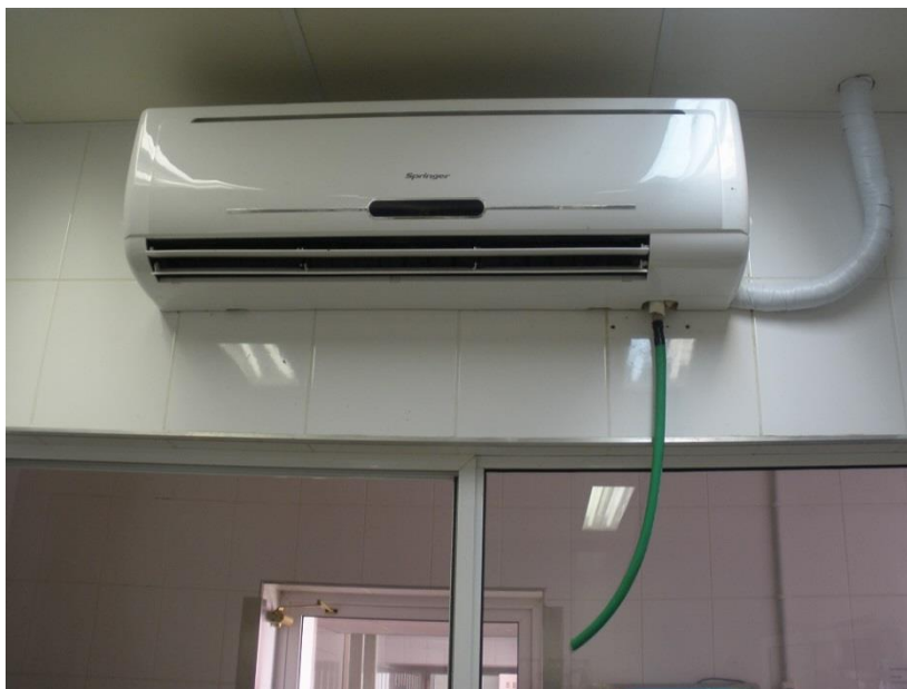
Figura 10: Dreno do Split com mangueira improvisada
