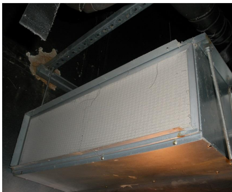
Figura 13: Filtro sujo na entrada de ar do condicionador
