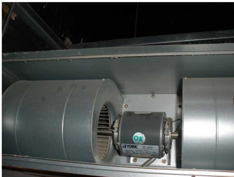
Figura 14: Entrada do ar condicionado sem filtro
