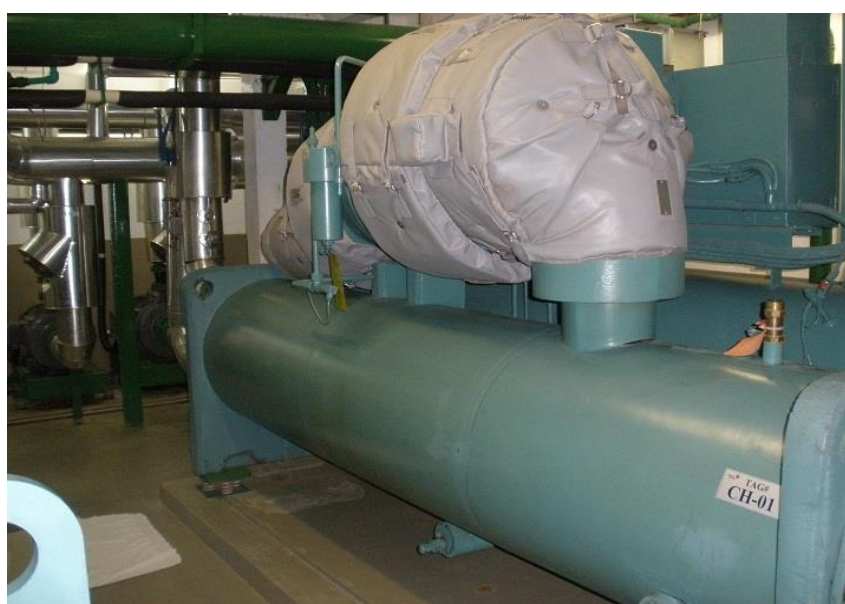
Figura 7: Parte traseira do Chiller
