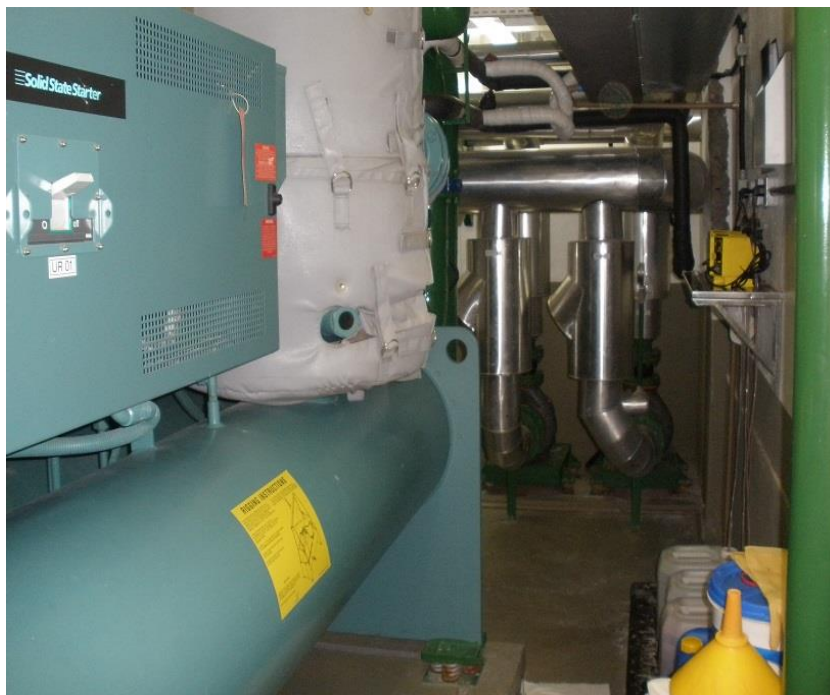
Figura 6: Parte Frontal do Chiller
