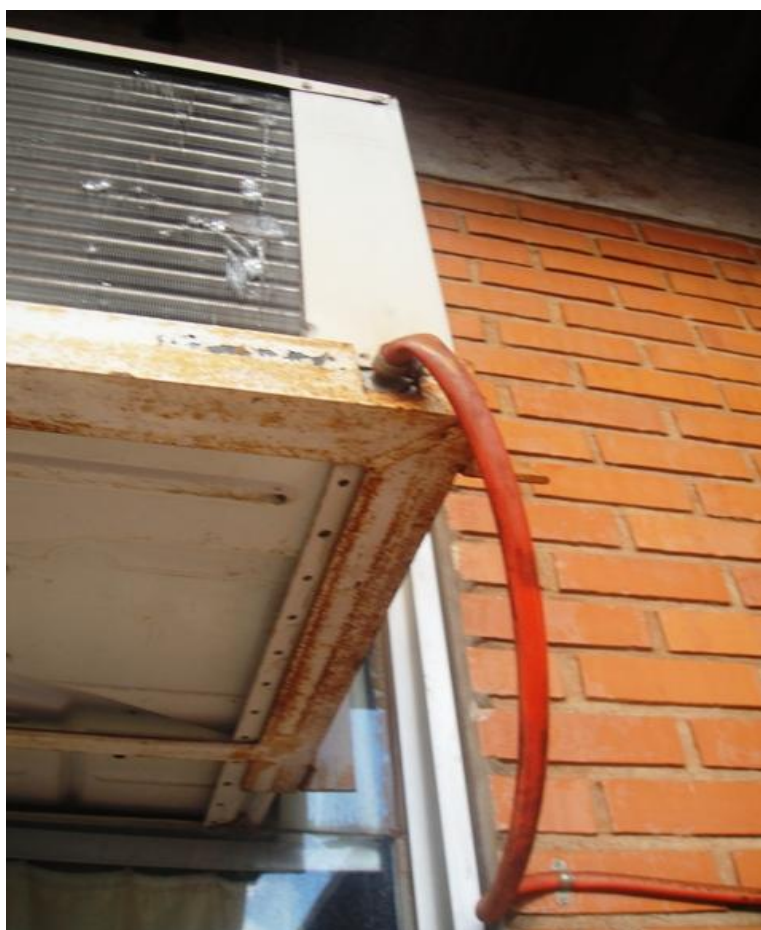
Figura 13 – Ar condicionado janela com dreno obstruído
