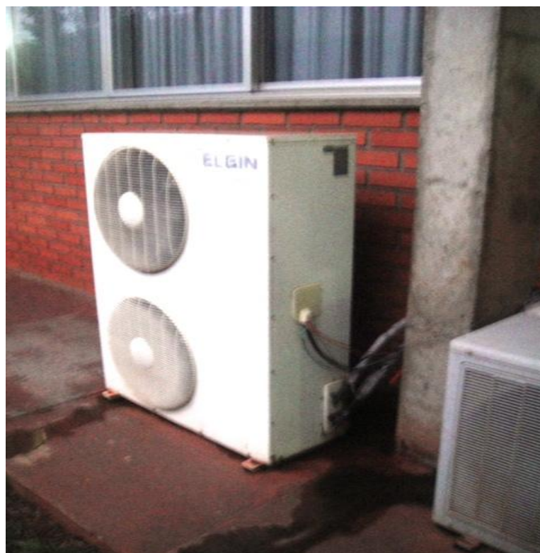
Figura 14 – Ar condicionado com vazamento
