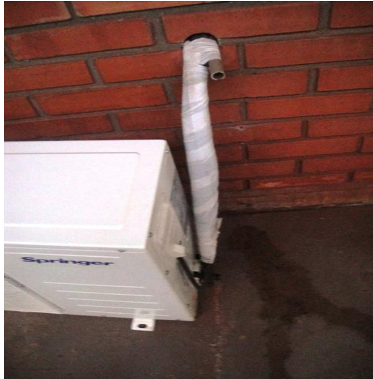
Figura 16 – Condensadora sem fixação
