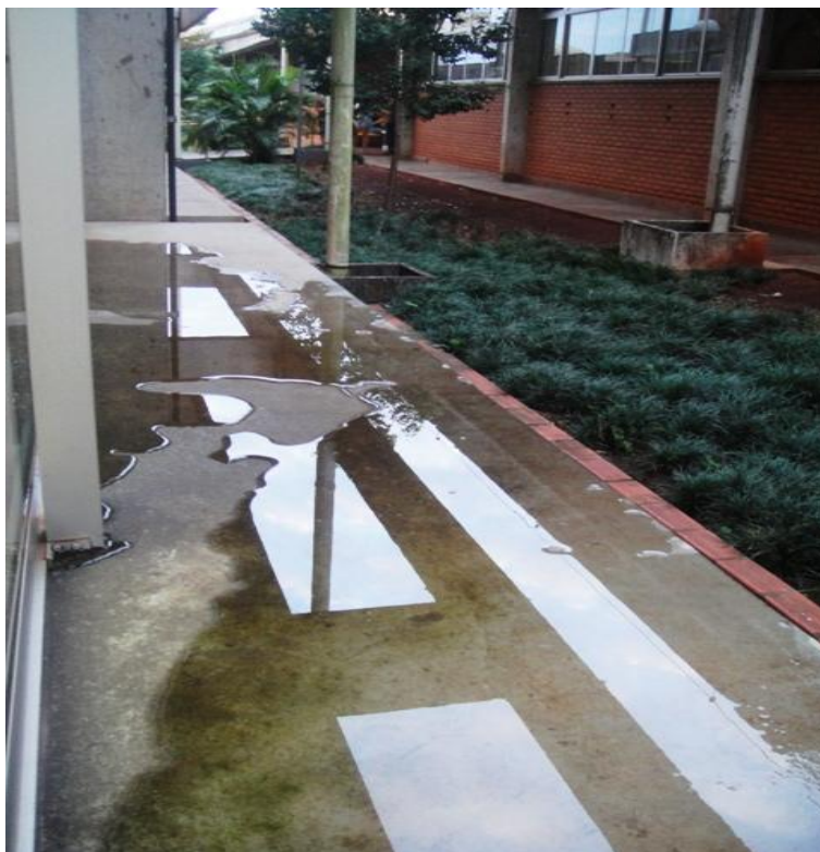
Figura 15 – Vazamento do dreno
