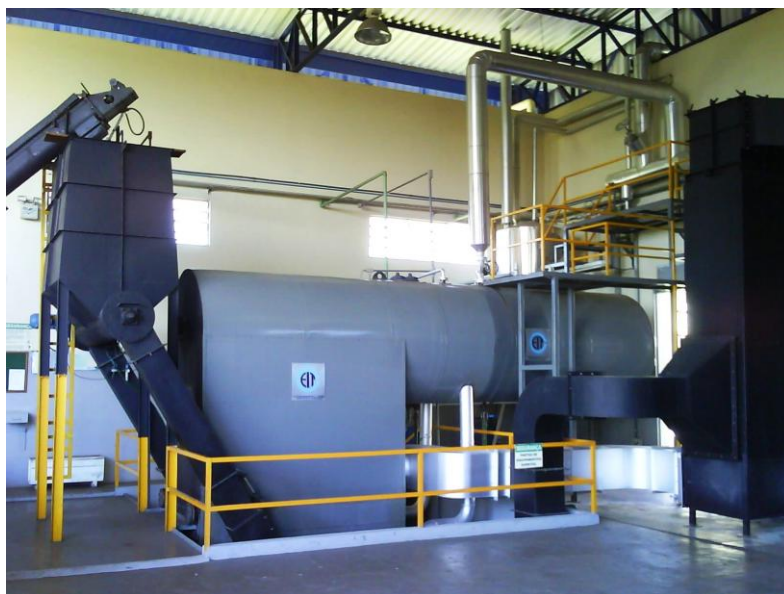
Fotografia 3. Caldeira para geração de vapor Fonte: Arquivo Pessoal
