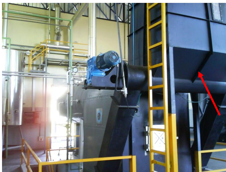
Fotografia 2. Moega de abastecimento da caldeira Fonte: Arquivo Pessoal
