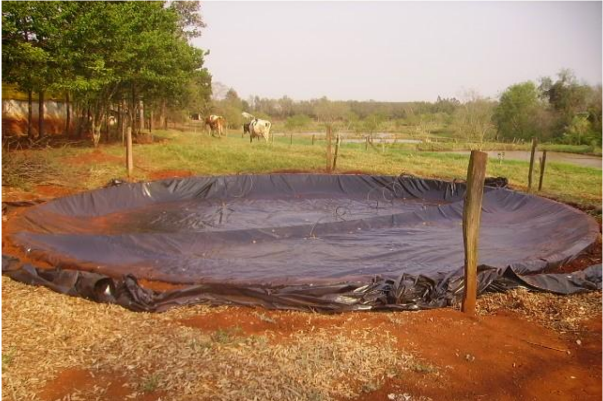
Figura 14 - Esterqueira depois de coberta.
