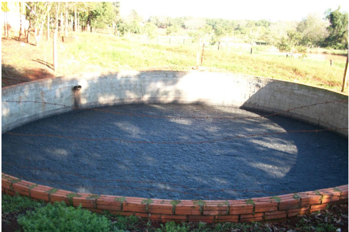
Figura 12 – Esterqueira a Céu Aberto.
