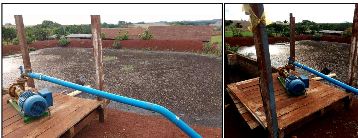
Figura 19 - Tanque de efluentes e bomba para fertirrigação Fonte: Aatoria Própria (2017).
