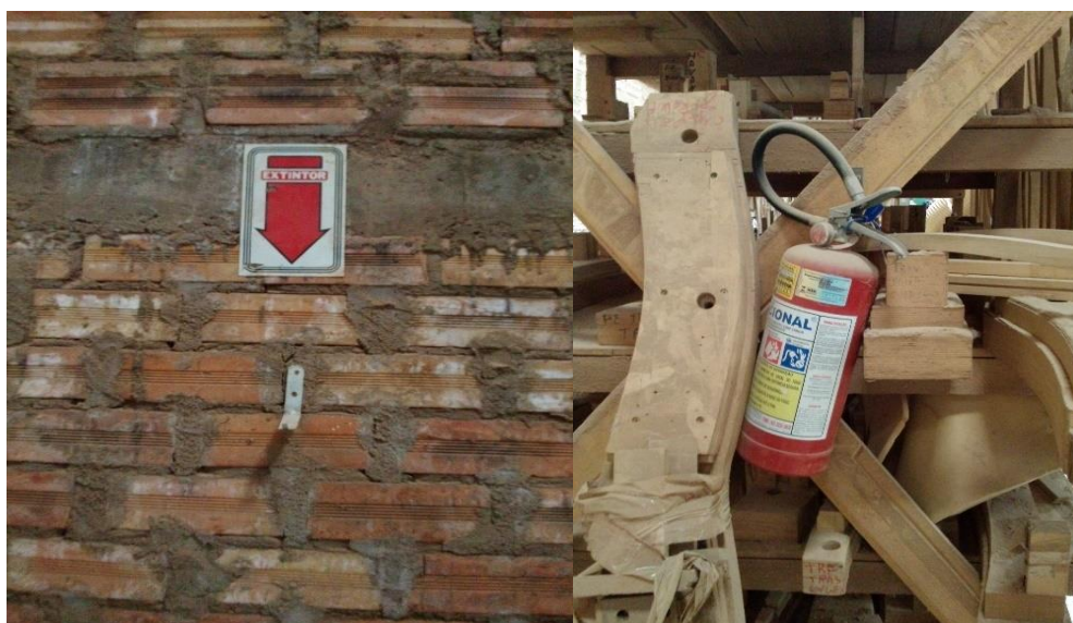
Fotografia 16 – Sinalização avulsa e extintor em local inapropriado. Fonte: Autoria própria.
