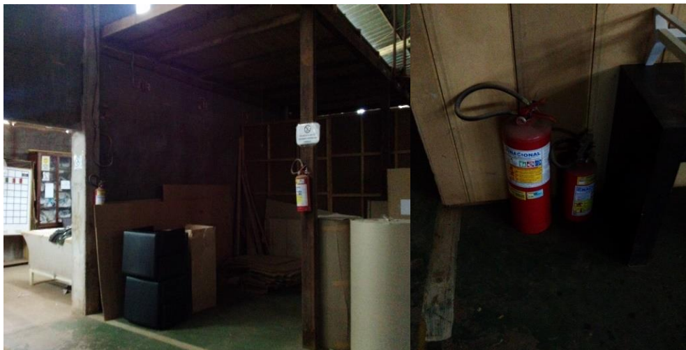
Fotografia 17 - Extintores muito próximos, localizados no chão e em difícil acesso. Fonte: Autoria própria.
