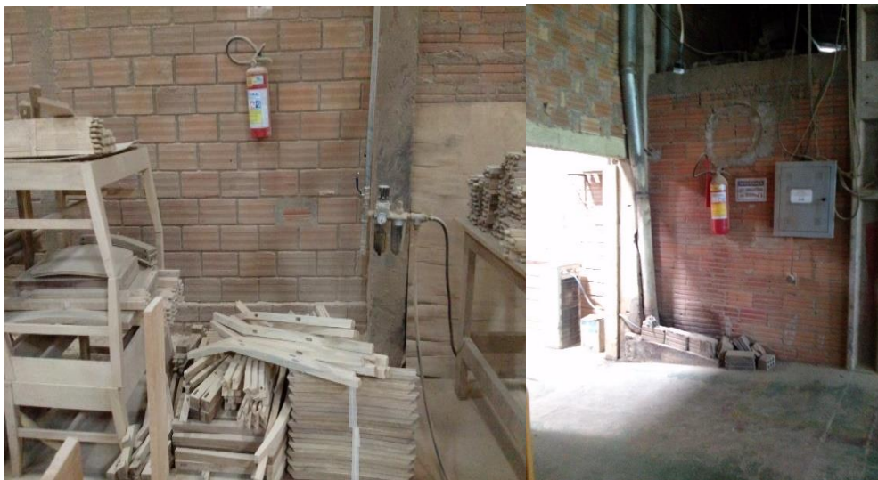
Fotografia 15 - Extintores em difícil acesso e sem sinalizações. Fonte: Autoria própria.
