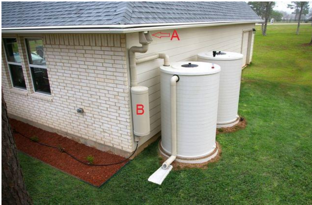
Figura 8 - Exemplo de construção com sistema de aproveitamento de água pluvial Fonte: Harvesting (2011).
