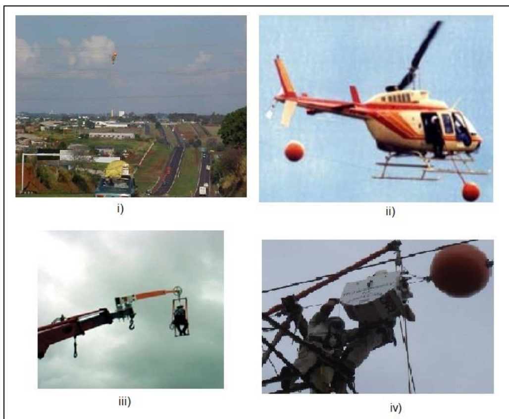
Figura 10– Exemplos de instalações de esferas sinalizadoras. Fonte: PIRES (2007).
