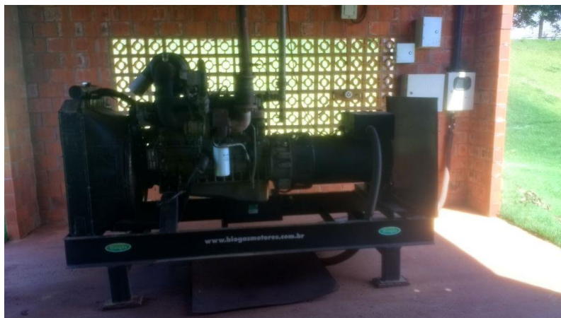
Figura 13 – Motor-gerador Fonte: Autoria própria
