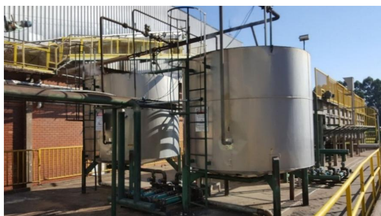
Figura 11 - Tanques de aquecimento. Fonte: Autoria própria (2018).
