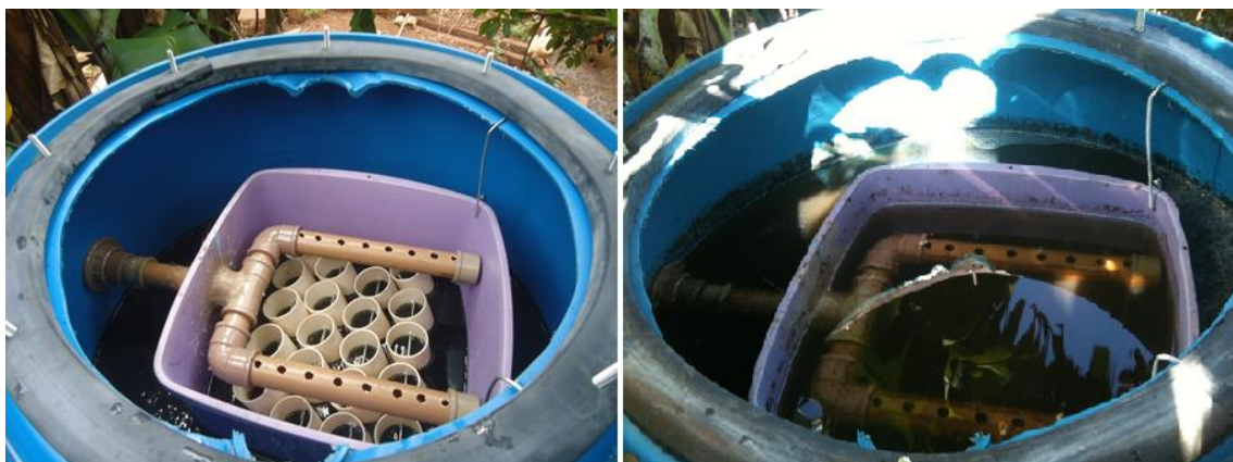
Figura 14 - Decantador Laminar inserido no Reator UASB.
