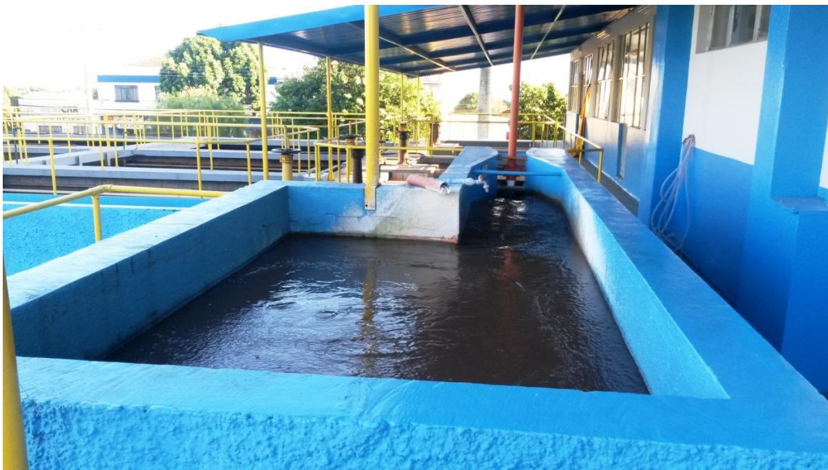
Figura 4 – Local onde a água bruta chega à estação de tratamento de água Fonte: Autoria Própria
