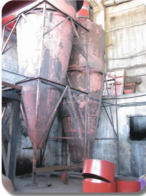
Figura 16 – Ciclone construído pela empresa X. Fonte: CMB Consultoria Ltda. (2012)
