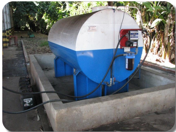
Figura 28 – Bomba de combustível com bacia de contenção Fonte: CMB Consultoria Ltda. (2012).
