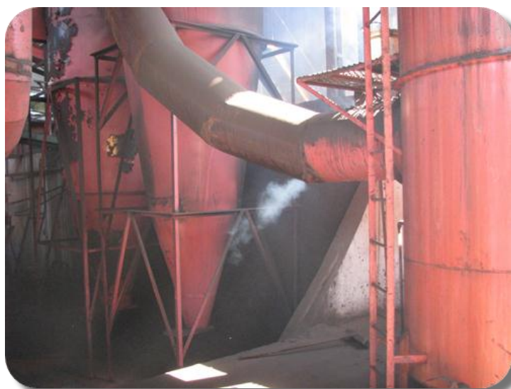
Figura 18 – Sistema de tratamento de gases com vazamentos. Fonte: CMB Consultoria Ltda. (2012).
