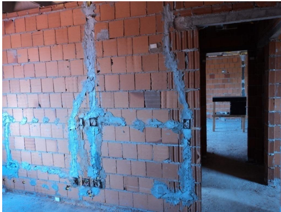
Figura 8 - Recortes feito na parede para instalação da rede elétrica e após o preenchimento com argamassa.
