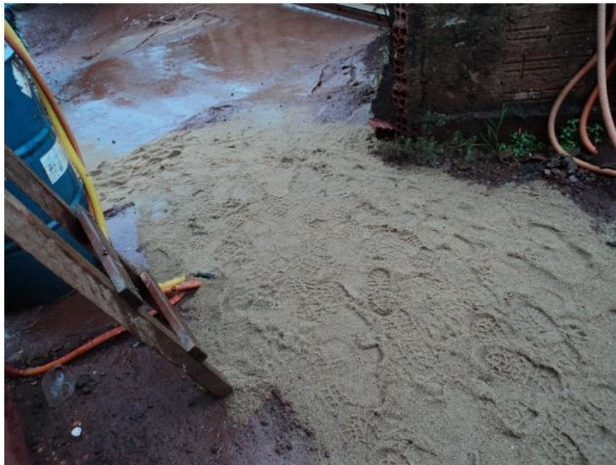
Figura 7 - Utilização excessiva de areia em casos de chuvas constantes, empreendimento A.
