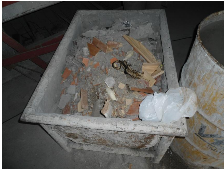
Figura 2 - Irregularidades na segregação do resíduos classe A por pavimento – empreendimento A.
