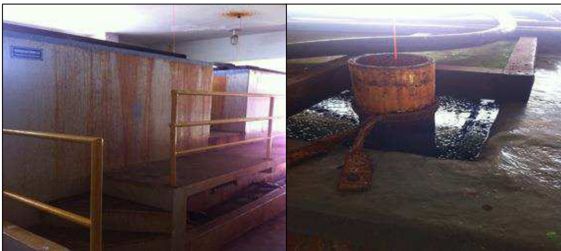
Figura 2: Situação do reservatório de cloreto férrico na estação ETA Cafezal.
