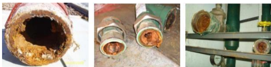
Figura 15 - Formação de incrustações nas tubulações
