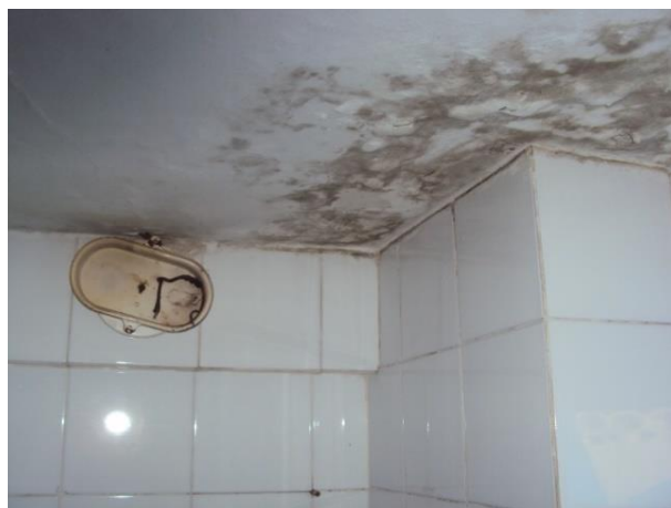
Figura 20 - Infiltração da água pluvial pela cobertura
