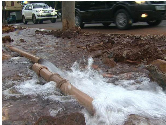
Figura 14 - Ruptura de tubulação por impacto
