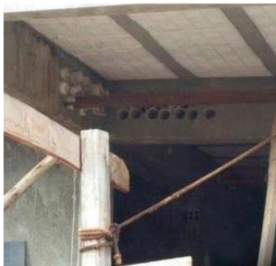
Figura 6 - Incompatibilização de projetos
