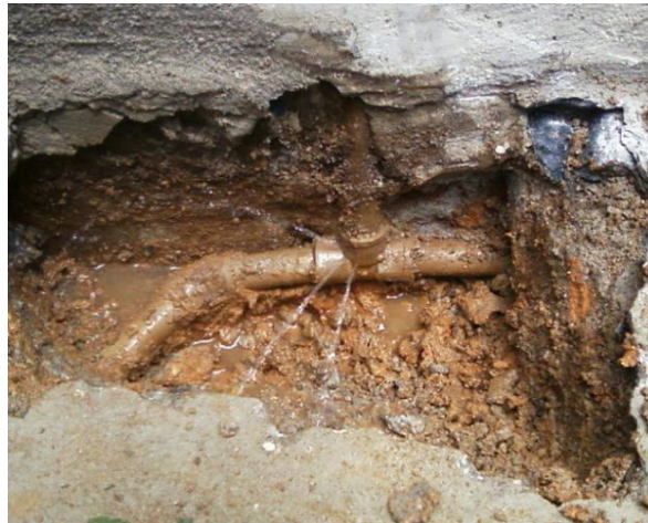
Figura 10 - Vazamento em tubulação enterrada
