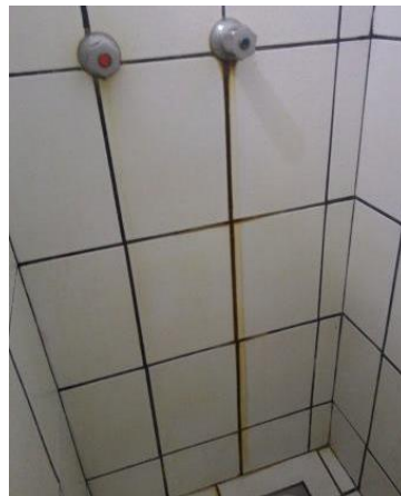
Figura 13 - Vazamento em registro
