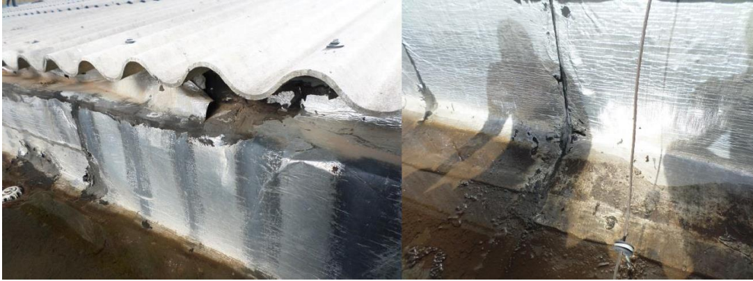
Figura 59 - Obstrução das calhas do bloco B
