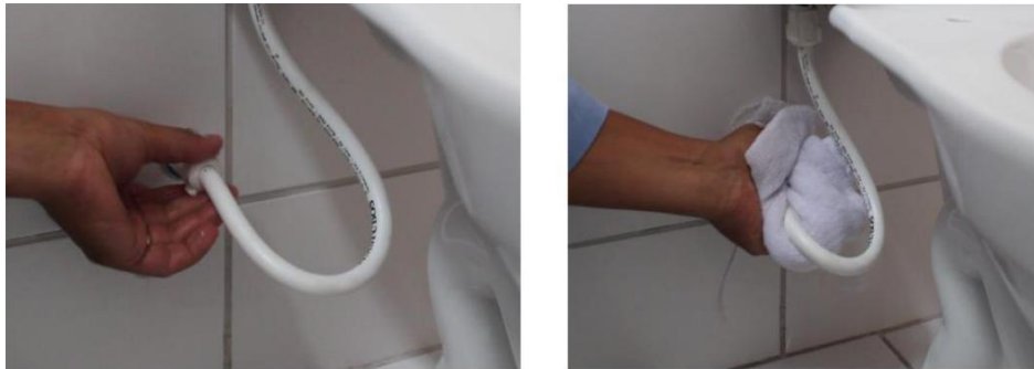
Figura 12 - Vazamento na instalação das bacias sanitárias
