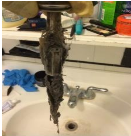
Figura 19 - Entupimento em pia de banheiro
