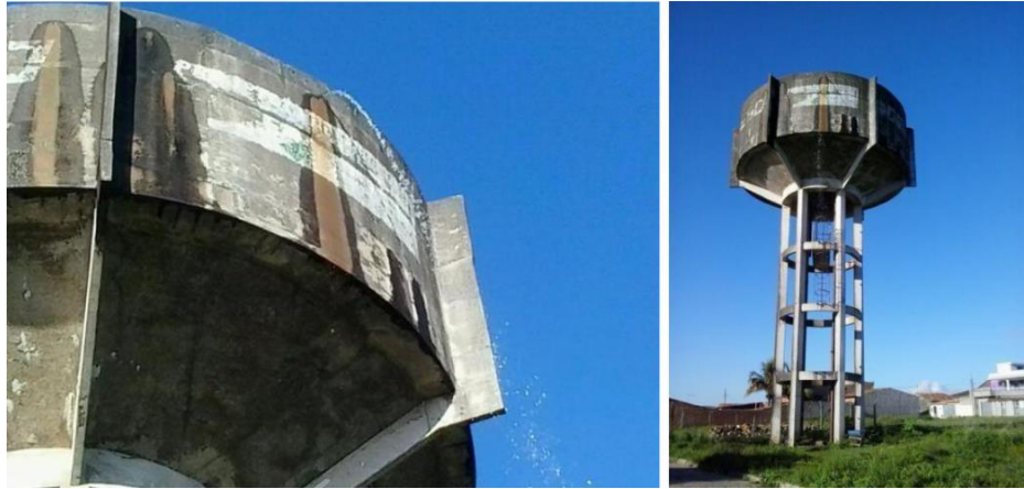
Figura 9 - Vazamento em caixa d'água
