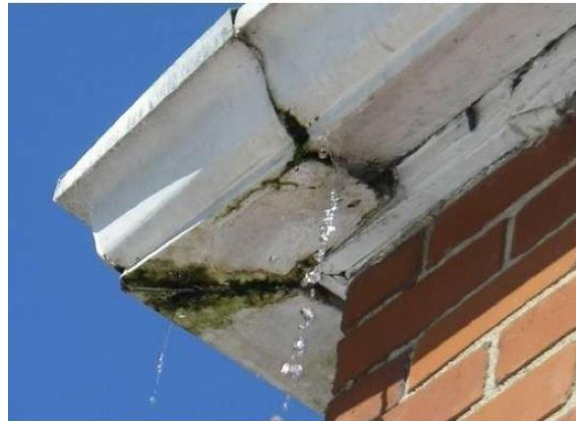
Figura 21 - Vazamentos em calhas
