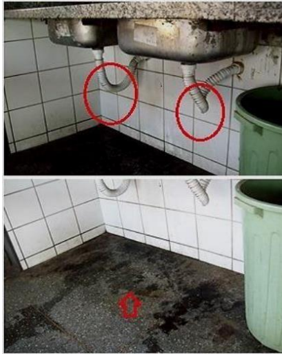
Figura 11 - Vazamento em pias
