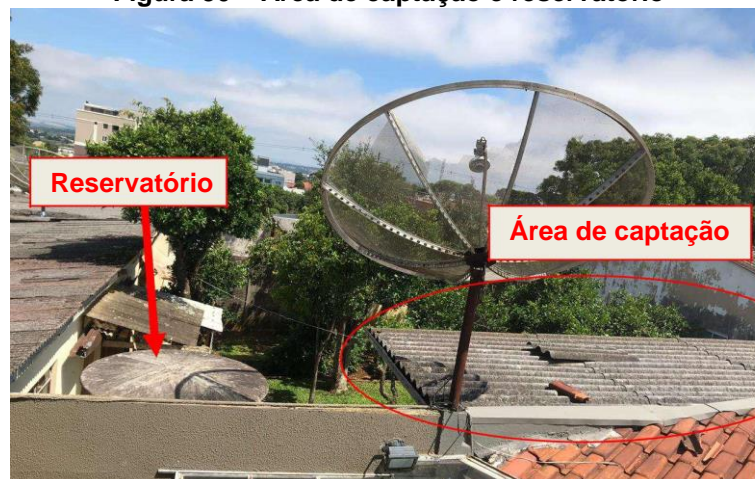
Figura 30 – Área de captação e reservatório
