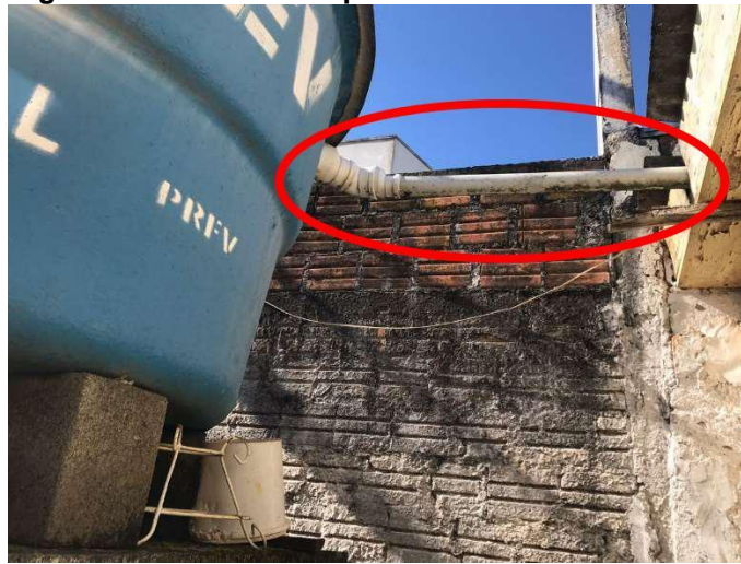
Figura 11 – Extravasor que direciona o excesso à outro telhado
