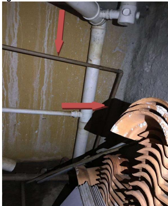
Figura 15 – Condutores horizontais e verticais
