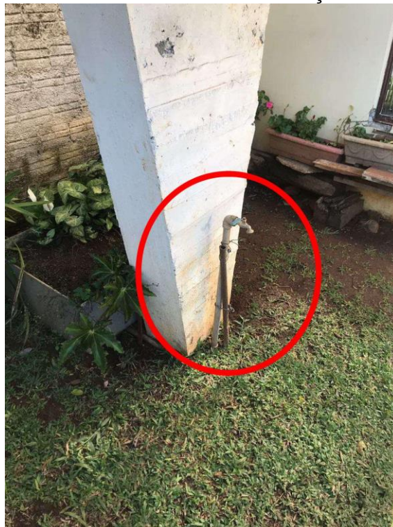
Figura 12 – Torneira com falta de indicação de não potabilidade
