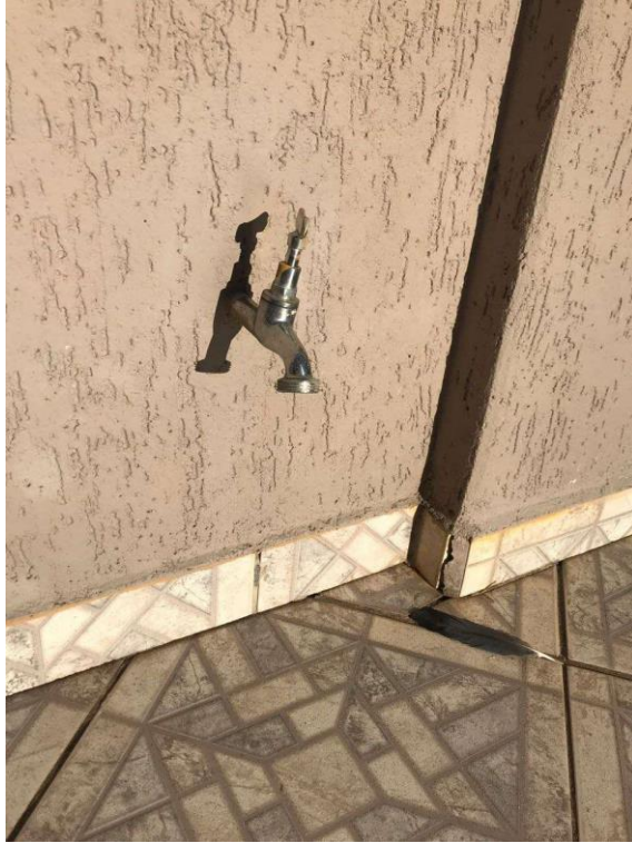
Figura 18 - Ponto de saída 02, com falta de indicação de não potabilidade
