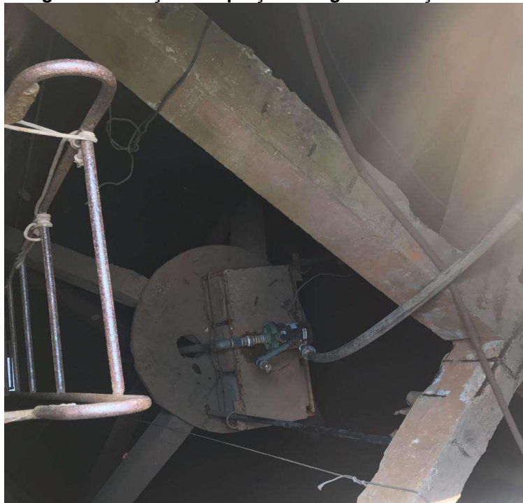
Figura 25 – Poço de captação de água do lençol freático (interior)
