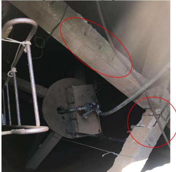
Figura 35 – Vigas internas ao poço com armaduras expostas
