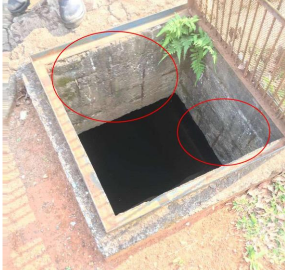
Figura 34 – Cisterna com armadura exposta
