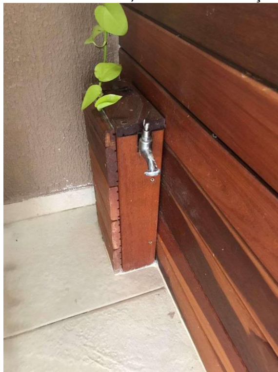
Figura 17 - Ponto de saída 01, com falta de indicação de não potabilidade
