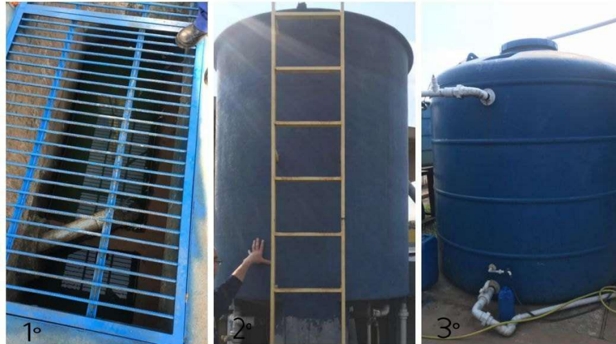
Figura 19 – Tanques para processos de tratamento de água
