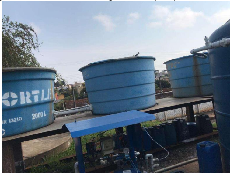
Figura 24 – Reservatórios de água tratada para posterior envio para a lavagem
