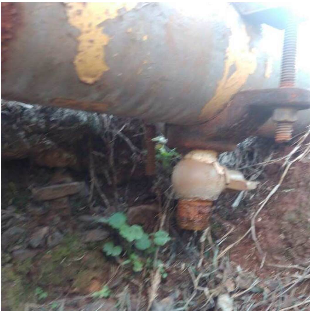
Figura 5: Registro de saída do biogás.
