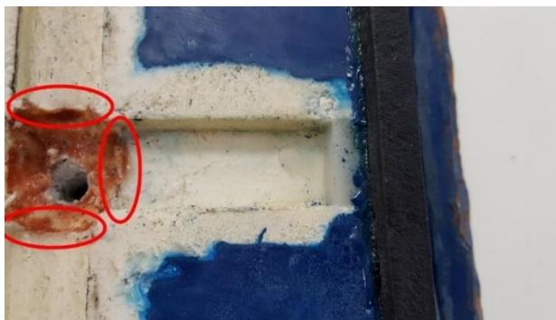
Figura 24 – Paredes próximas as entradas das cavidades danificadas
