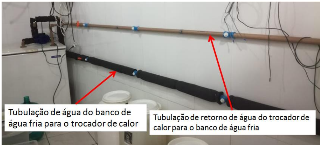
Figura 37 – Tubulação de saída e retorno de água para o banco de água fria.
