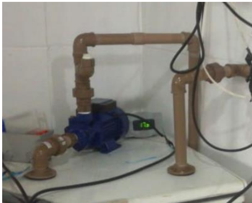
Figura 35 – Saída e retorno de tubulação do banco de água fria sem isolamento térmico.
