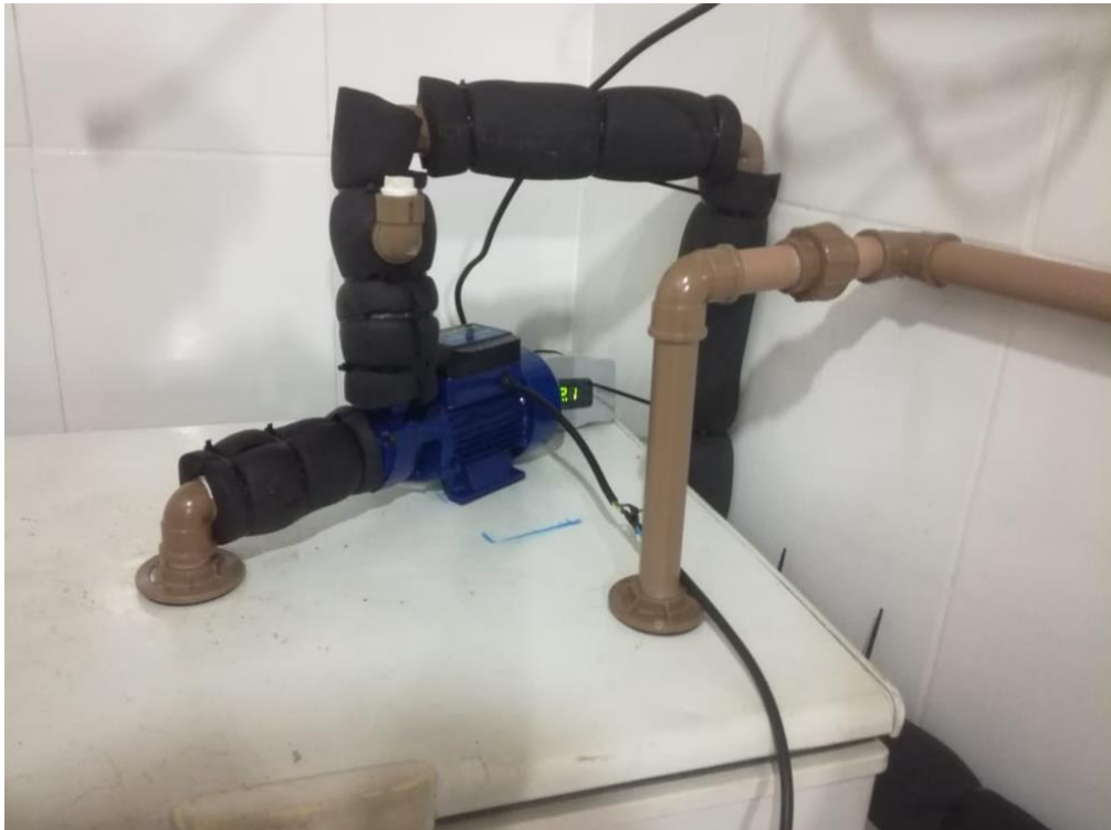
Figura 36 – Saída e retorno de tubulação do banco de água fria com isolamento térmico.
