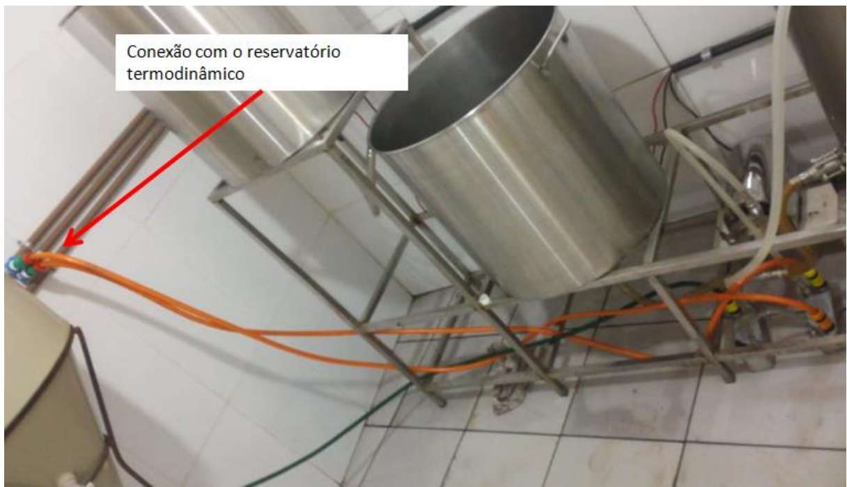
Figura 32 – Conexão dos trocadores de calor com o reservatório termodinâmico.
