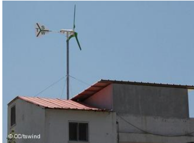
Figura 1 Microgerador eólico instalado no telhado de uma residência (Reuter & Pontes, 2011)
