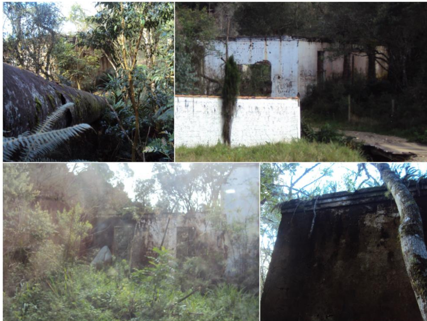
Figura 18 – Casa de Força MCH Roncador
