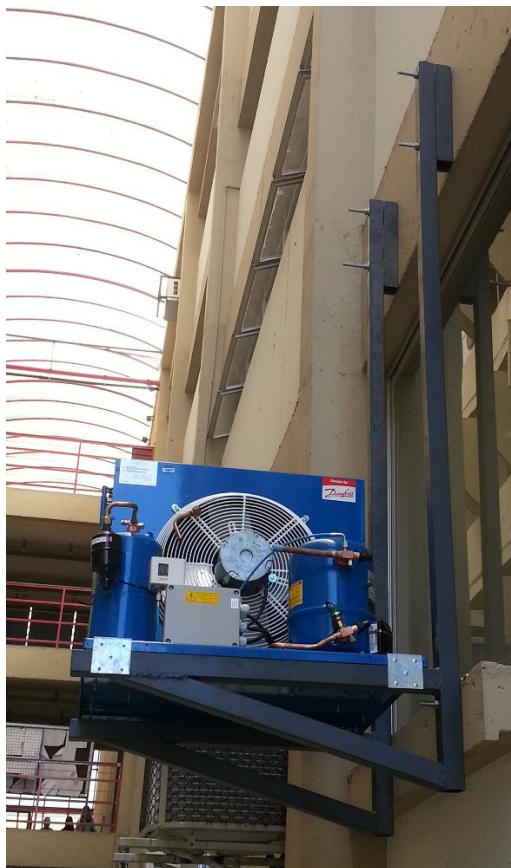
Figura 21. Unidade condensadora do sistema de refrigeração da bancada
