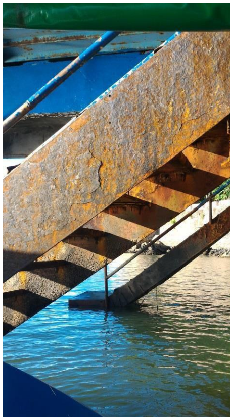
Figura 1 Exemplo de corrosão uniforme em uma escada exposta a ambiente marinho. Fonte: Fotografia do acervo do PO (2017).
