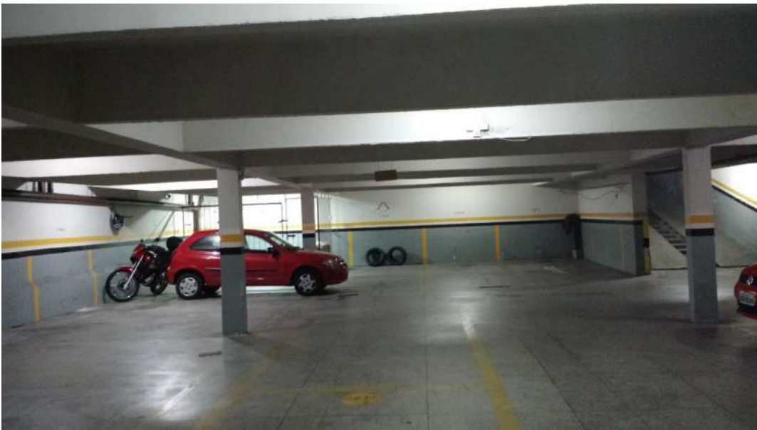
Figura 17 - Iluminação do Subsolo do Estacionamento do Edifício.
