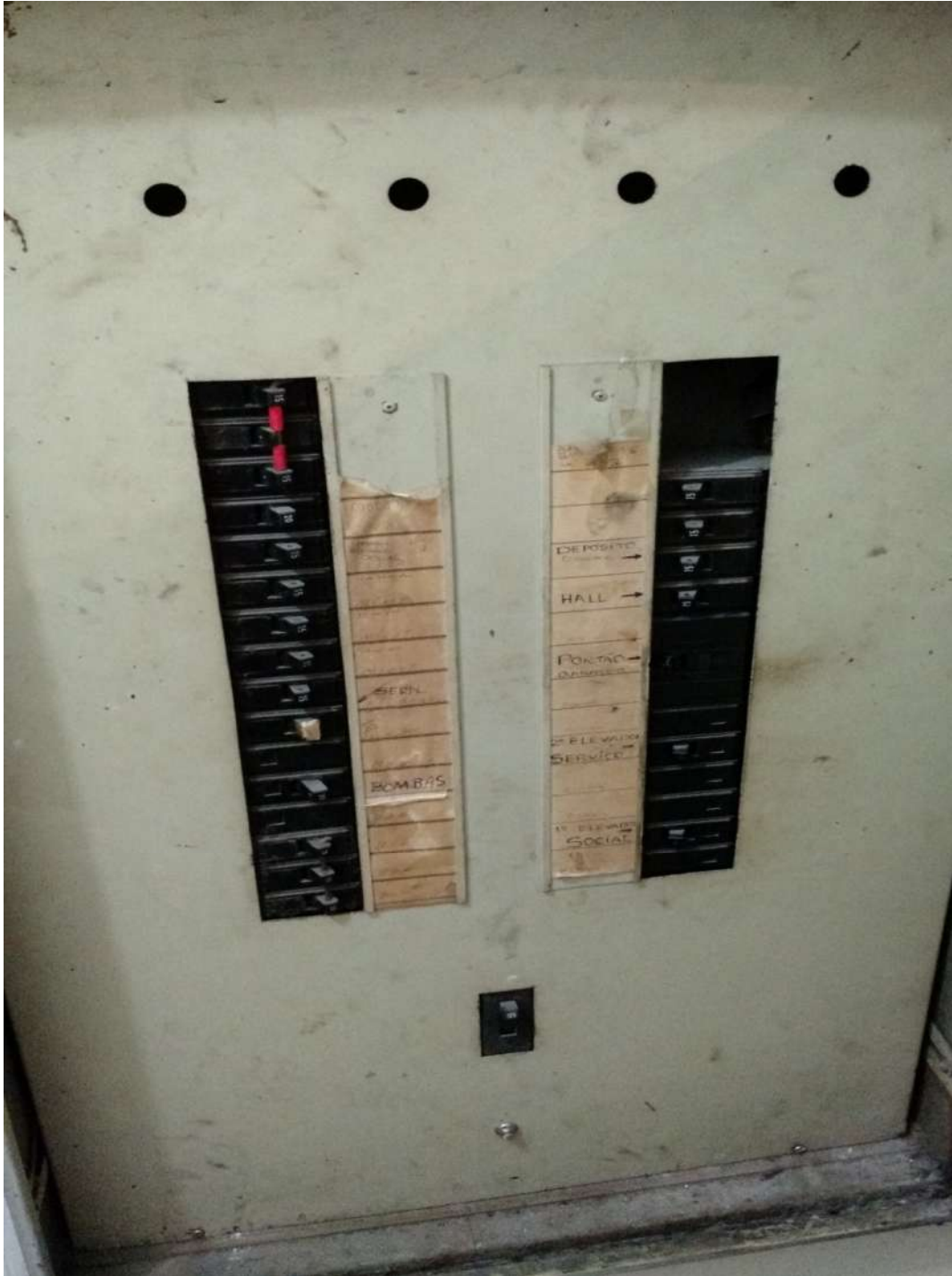
Figura 10 – Situação do Quadro Geral de Distribuição.
