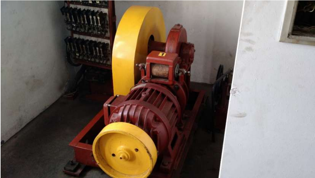
Figura 18 - Motor Número 1 da Casa de Máquinas.
