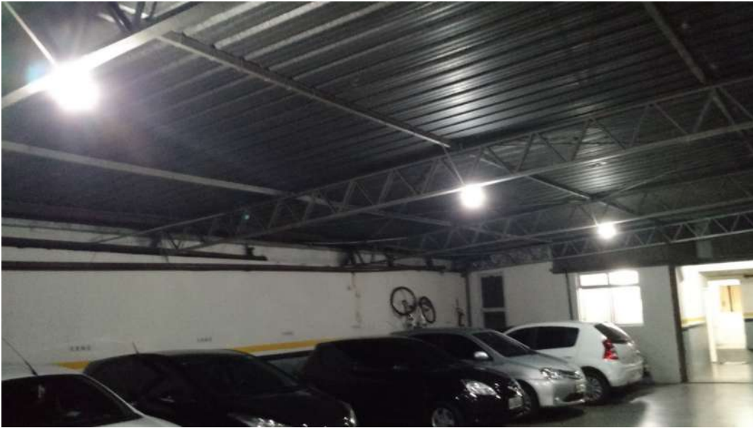
Figura 16 - Iluminação Primeiro Andar do Estacionamento do Edifício.
