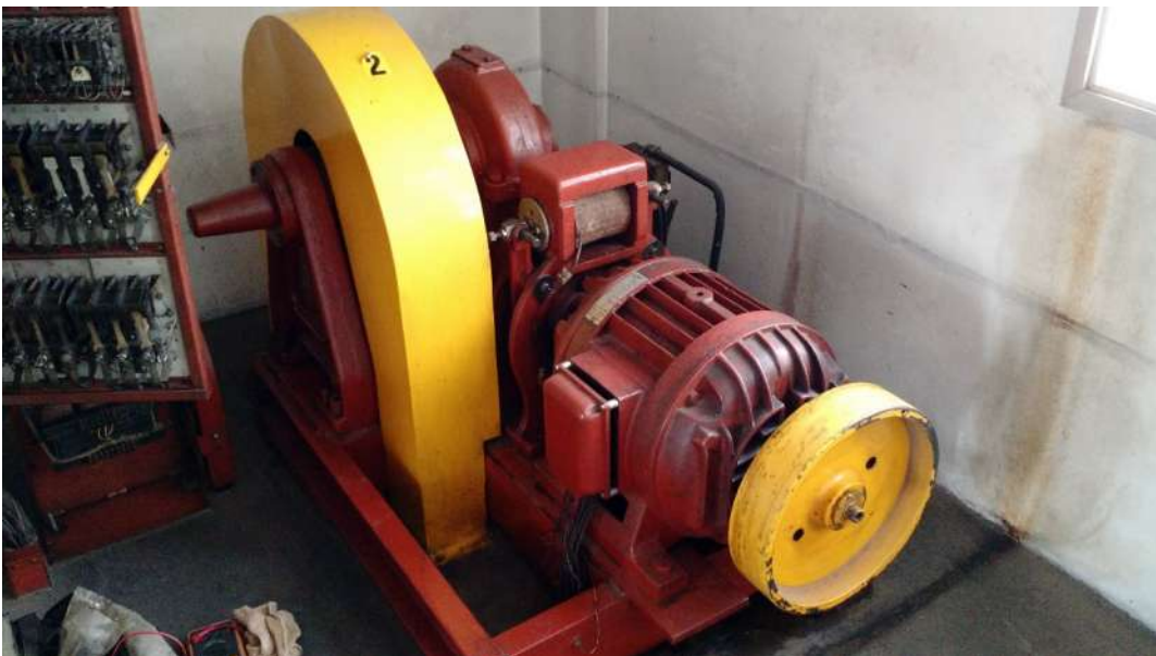
Figura 19 - Motor Número 2 da Casa de Máquinas.
