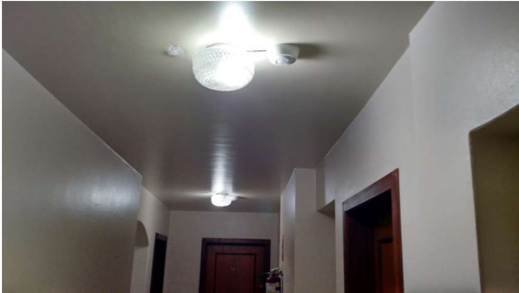
Figura 14 - Iluminação Corredores dos Andares do Edifício.
