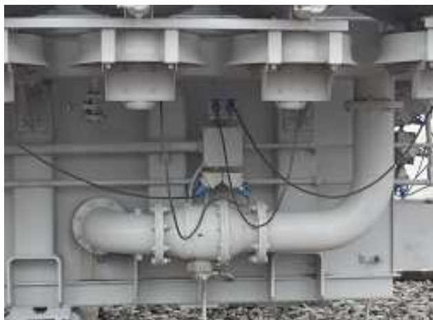
Figura 13 – Sistema de circulação forçada de óleo instalado em transformador de potência 230/69/13,8 kV 150 MVA.
