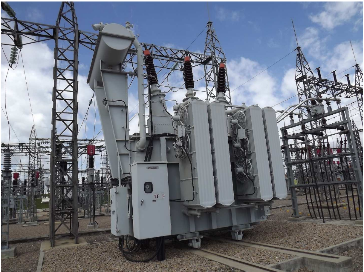
Figura 1 – Transformador de Carga Trifásico 69 / 13,8 kV. Fonte: Autoria própria (2013).
