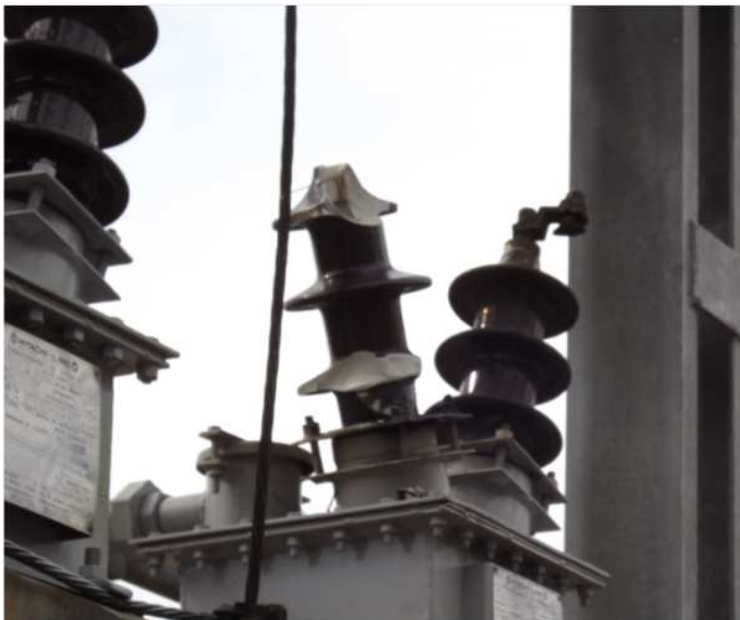
Figura 2 - Ruptura de Isolador em Transformador de Potencial 13,8 kV instalado dentro da área de atuação da proteção diferencial – causa de desligamento de transformador. Fonte: Autoria própria (2012).
