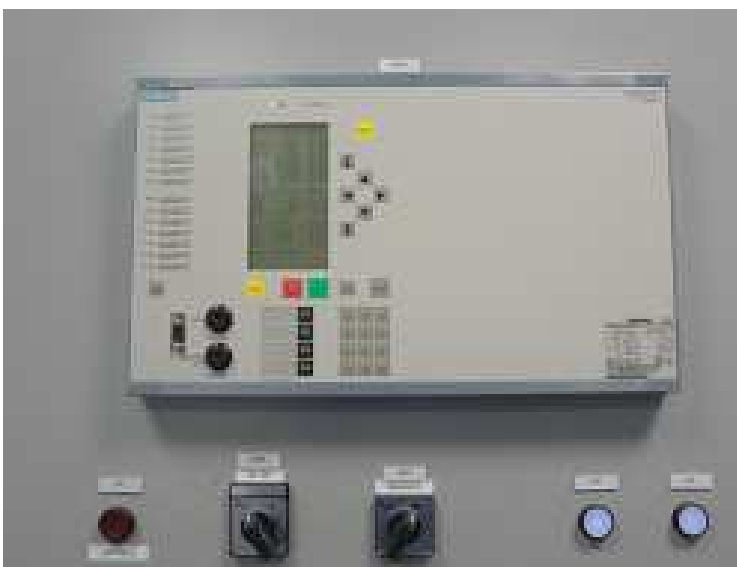
Figura 15 – Relé que engloba todas as funções de proteções de um transformador de potência 230/69/13,8 kV 150 MVA. Fonte: Aatoria Própria (2014).
