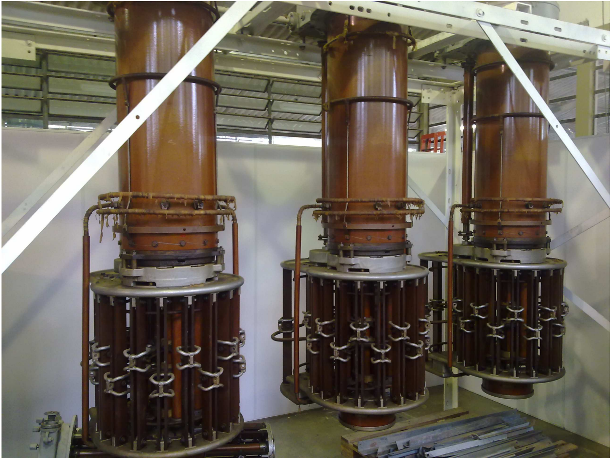
Figura 10 – Comutador de Derivação sob Carga de Transformador Trifásico Extraído para Manutenção. Fonte: Autoria Própria (2012).
