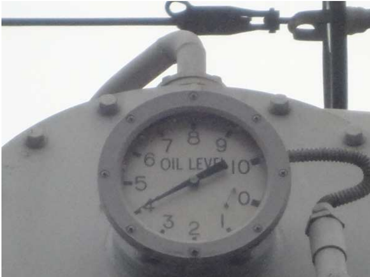
Figura 14 – Indicador de nível de óleo instalado em transformador de potência 230/69/13,8 kV 150 MVA. Fonte: Aatoria Própria (2014).
