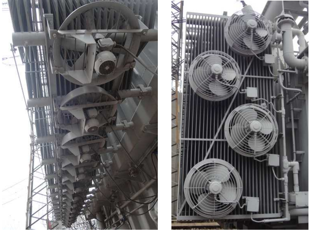
Figura 12 – Conjunto de ventiladores instalados em radiadores de transformadores de potência 230/69/13,8 kV 150 MVA.
