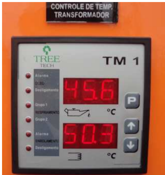
Figura 11 – Indicador de temperatura do óleo (45,6°C) e enrolamentos (50,3°C) de um transformador de potência 230/69/13,8 kV 150 MVA.
